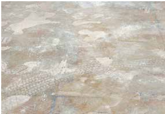
Restes de matériaux de pose
